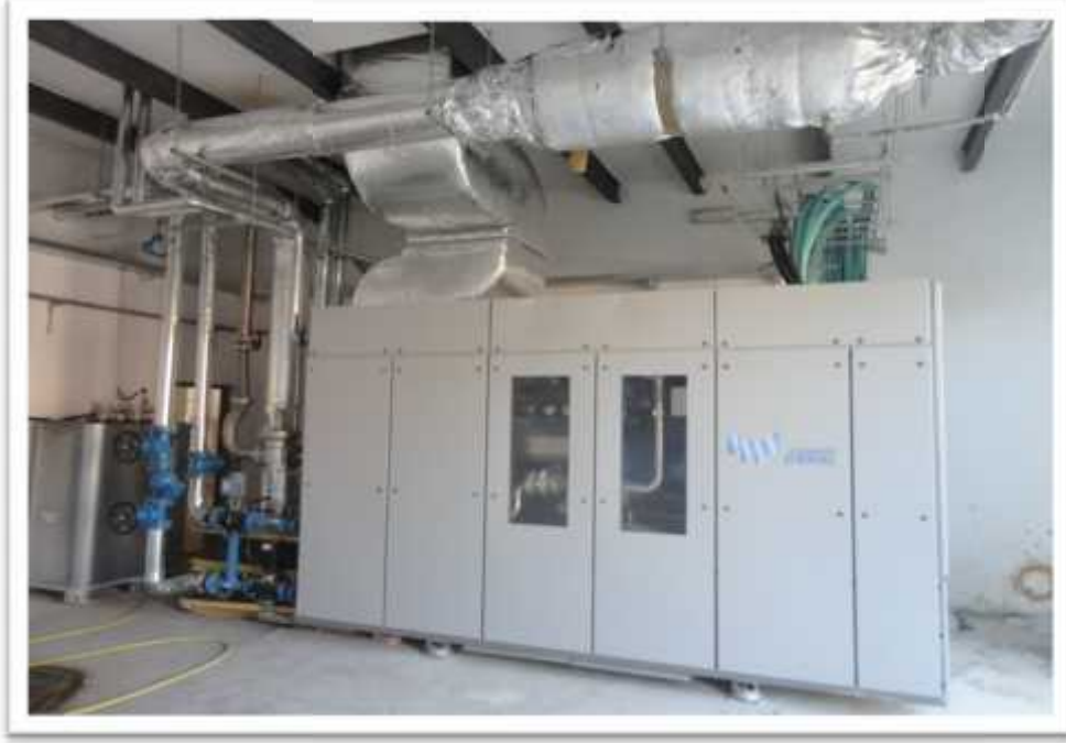
وحدة توليد الطاقة الكهربائية والحرارية
