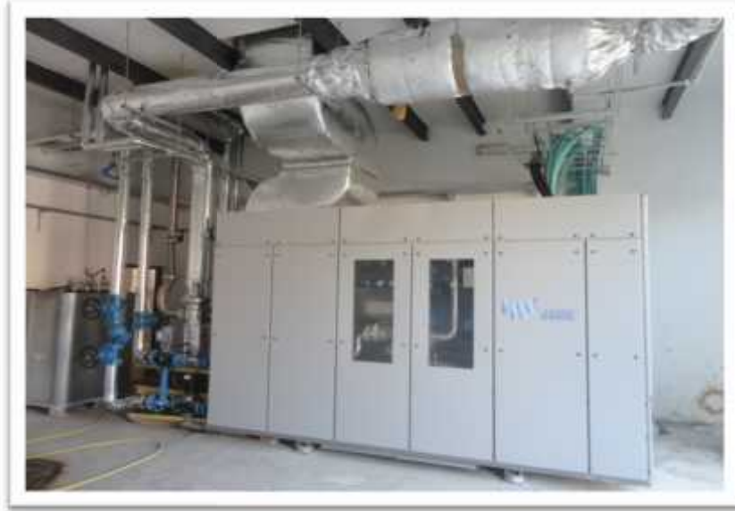
وحدة توليد الطاقة الكهربائية والحرارية
