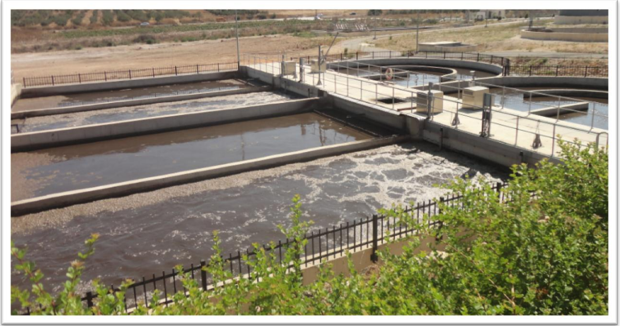
صورة تظهر وحدات التهوية
