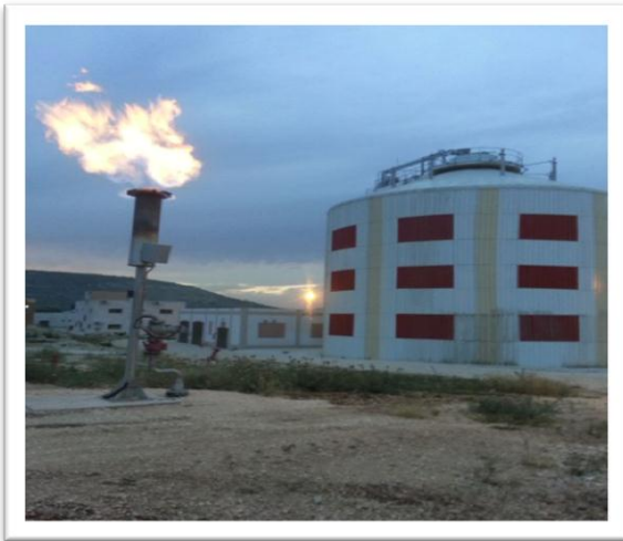
صورة تظهر الهاضم اللاهوائي وشعله الغاز
