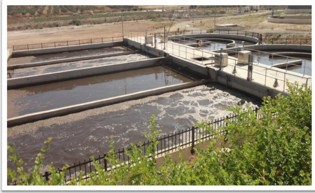
صورة تظهر وحدات التهوية
