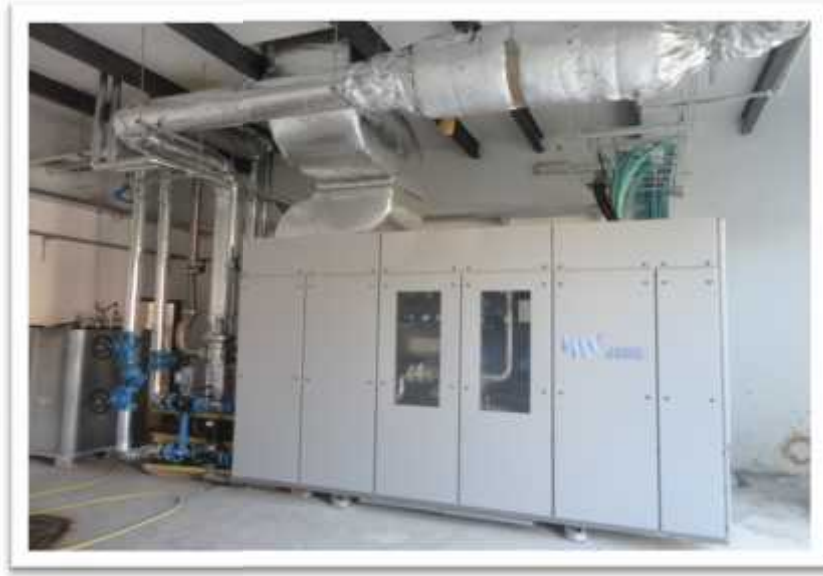
وحدة توليد الطاقة الكهربائية والحرارية
