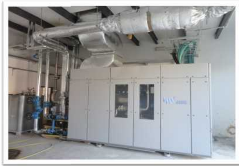
وحدة توليد الطاقة الكهربائية والحرارية
