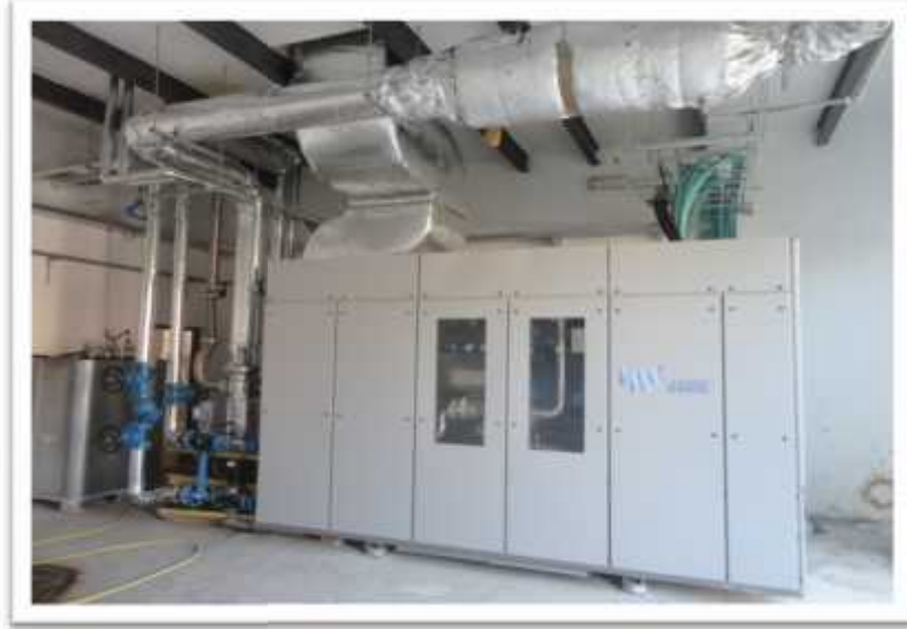
وحدة توليد الطاقة الكهربائية والحرارية
