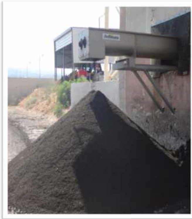
الحمأة الناتجة من وحدة عصر الحمأة
