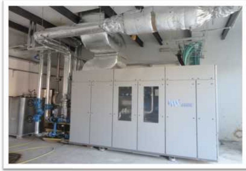
وحدة توليد الطاقة الكهربائية والحرارية
