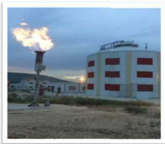
الهاضم اللاهوائي وشعله الغاز
