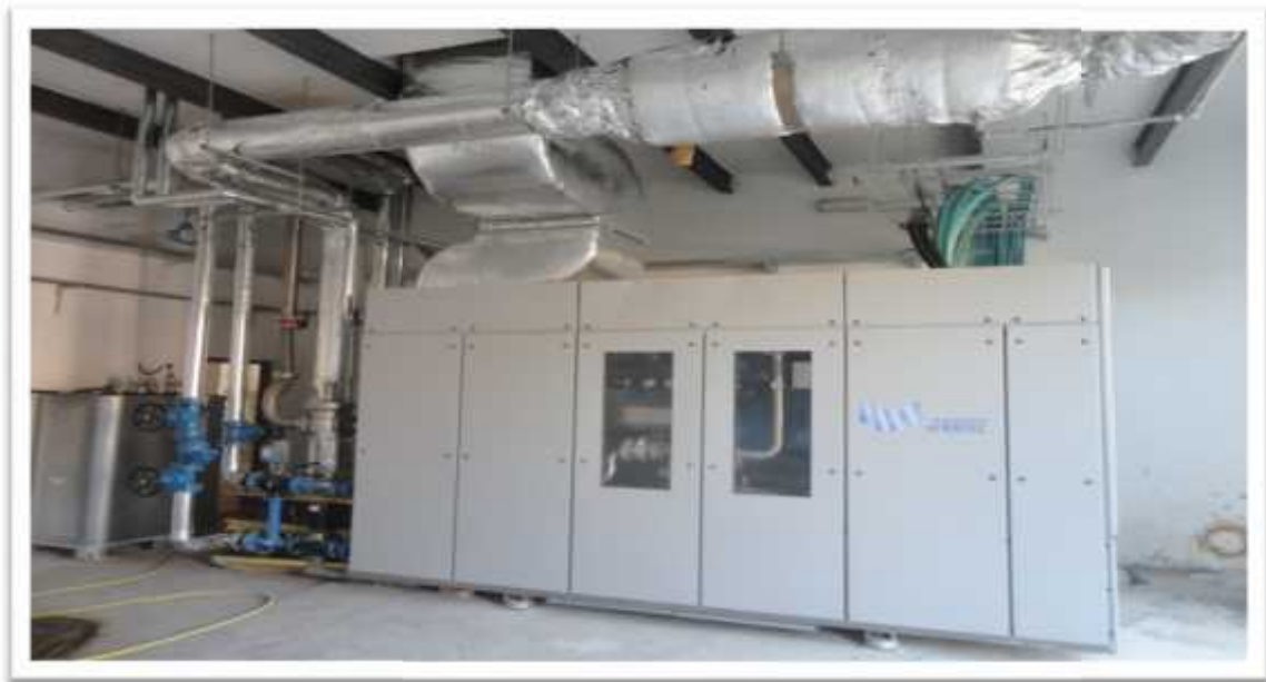
وحدة توليد الطاقة الكهربائية والحرارية
