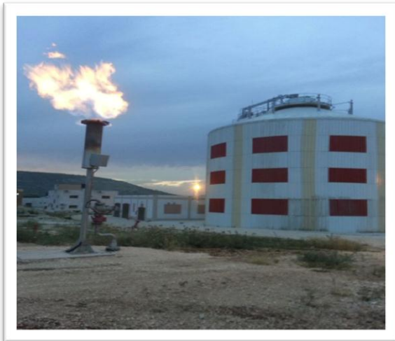
صورة تظهر الهاضم اللاهوائي وشلعة الغاز
